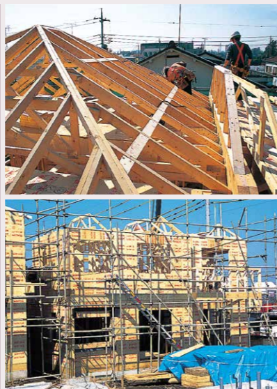
06 小屋組工事を行い、屋根垂木を組みます。この時、屋根の吹き上げを防ぐために、垂木は2×4工法独自の補強金物・ハリケーンタイで軒裏から壁にしっかりと緊結します。
